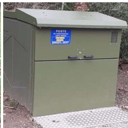
Mise en place d'un transformateur, et modification du réseau pour renforcer la fourniture électrique du Hameau de Belherbette
